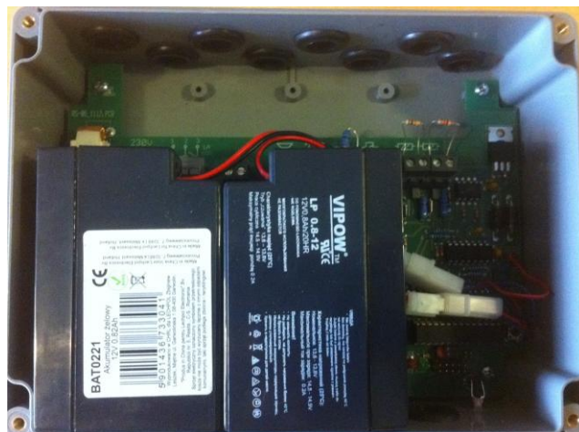
Fot.2. Widok wnętrza centrali z podłączonymi akumulatorami
